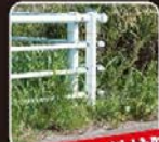
ガードレールの鉄柱脇
